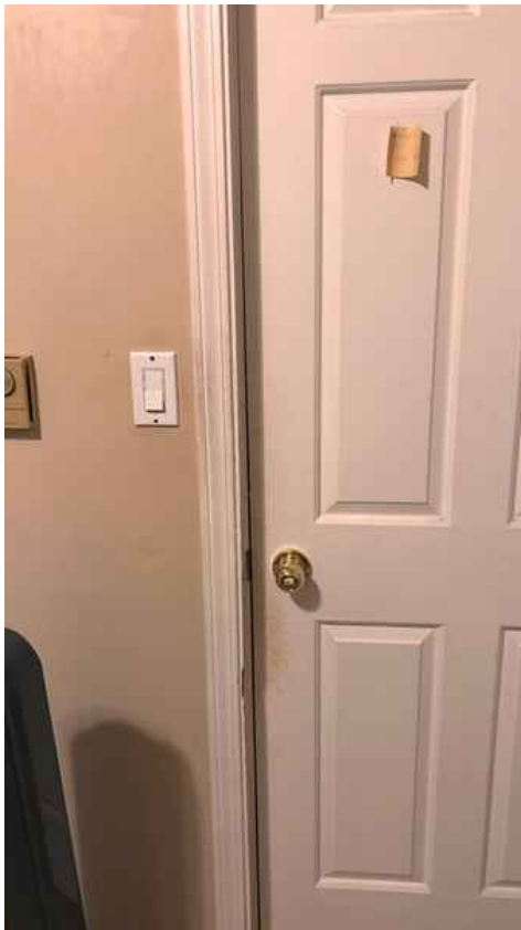
Unit B Bedroom door misaligned
